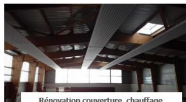
Rénovation couverture, chauffage, éclairage du centre sportif J. Le Bas à Saint-Lô
